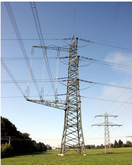
Abzweigmast der 380 kV-Leitung von Rommelsbach nach Reicheneck © Speifensender ( http://commons.wikimedia.org/wiki/File:Stromleitung_Reicheneck,_Rommelsbach,_Sondelfingen_-_West_-_20090909-02.jpeg?uselang=de ). CC BY-SA 3.0 Filename: Stromleitung Reicheneck, Rommelsbach, Sondelfingen - West - 20090909-02.jpeg
